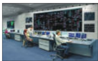
Instalaciones de REE.
